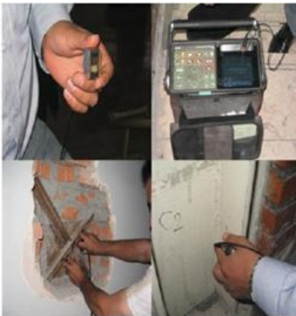
زمایش UT در سازه فولادی (جهت ۱- تعیین عمق ترکها و شیارهای مویی ۲- تعیین ضخامت پوشش (رنگک) ۳- تعیین عمق زنگ زدگی (خوردگی فولاد))
